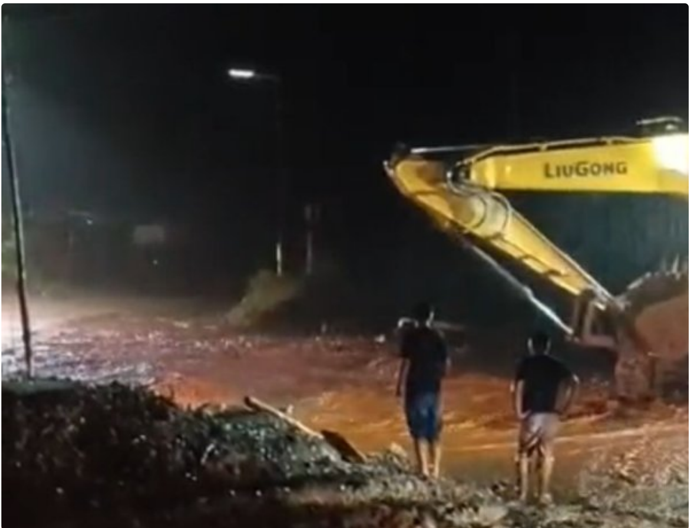
Tampak alat berat ekskavator diturunkan membersihkan lumpur tambang yang menggenangi jalan trans Sulawesi di Solonsa Jaya
